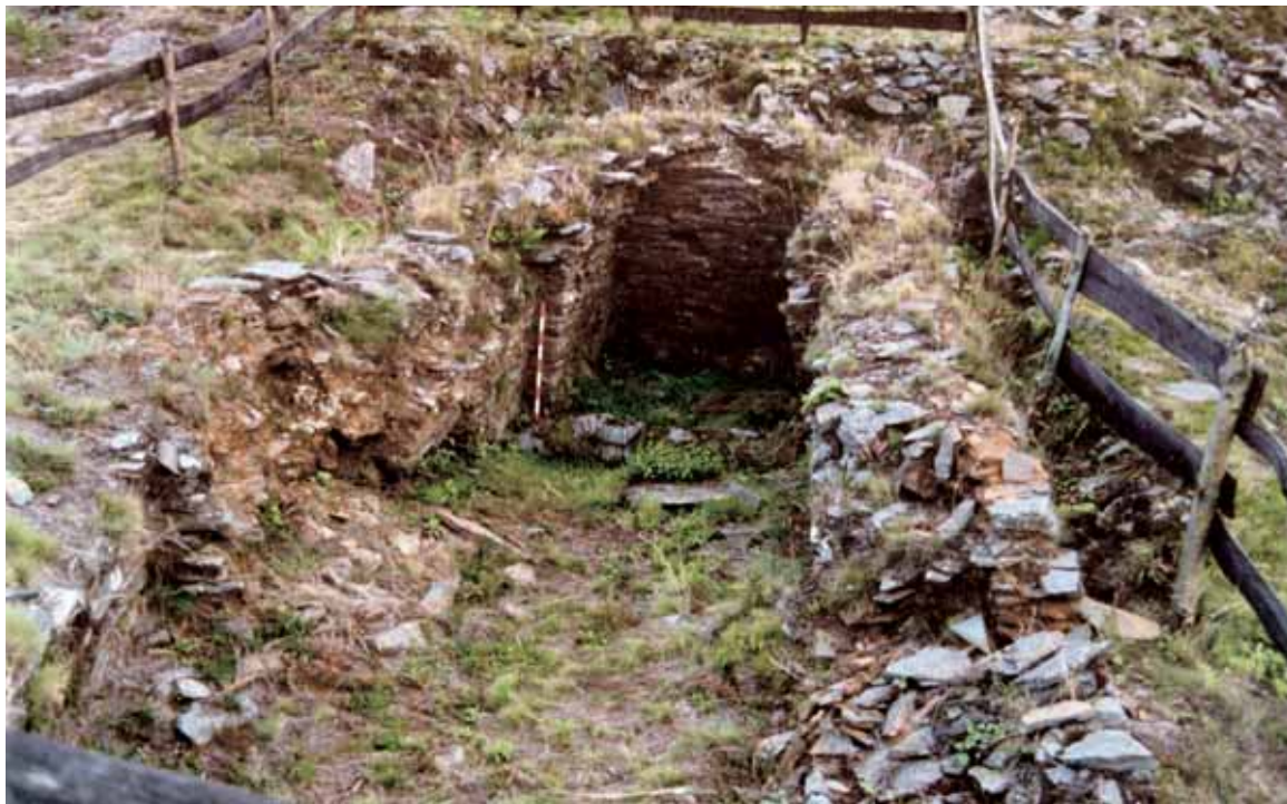
▲ Aspecto del segundo edificio termal tras el desbroce de vegetación previo a la intervención.
