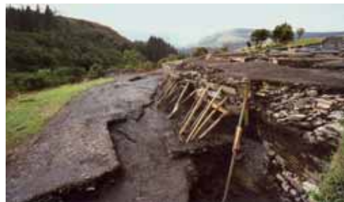
▲ El pronunciado desplome de las murallas, ocasionado por sucesivos empujes sísmicos, requirió su progresivo apuntalamiento hasta completar su excavación y estudio.
